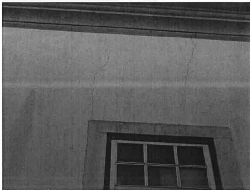
Foto 9 ( Fissuras no exterior da empena )
