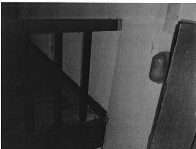
Foto 4 ( Descolamento pavimento e corrimão de parede, sótão)
