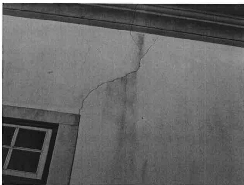
Foto 8 ( Fissuras no exterior da empena
