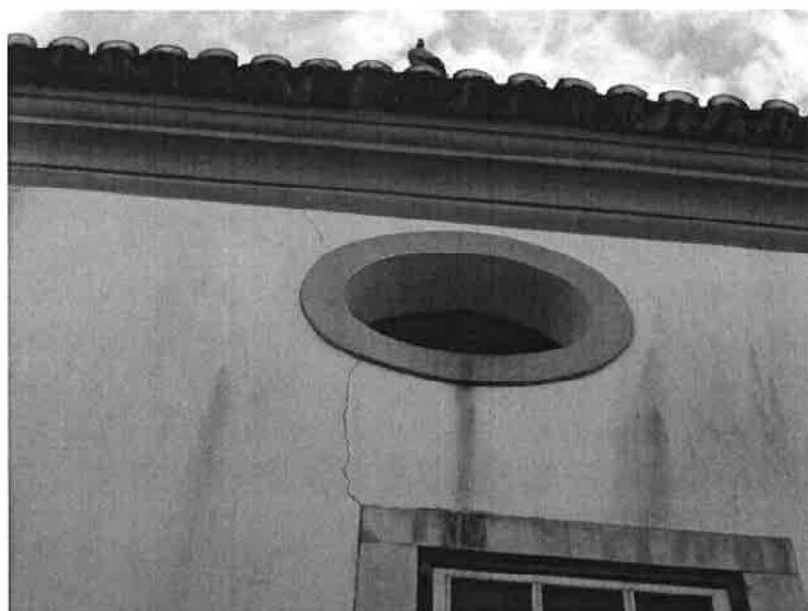
Foto 10 ( Fissuras no exterior da empena )
